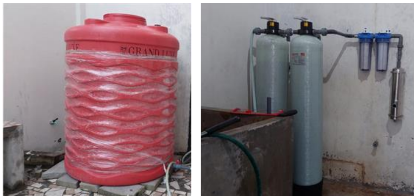
Gambar 5. Instalasi Alat Filtrasi + Membran di Desa Tinggiran II Luar
