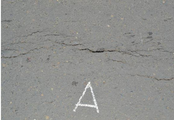
Gambar 1. Cracking permukaan jalan
